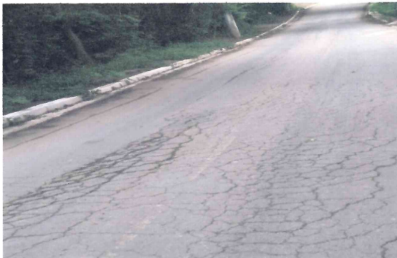
Asfalto danificado na Estrada Itacoti (Roque Rodrigues), no Bairro São João, após obra da Sabesp/ Complexo São Lourenço
