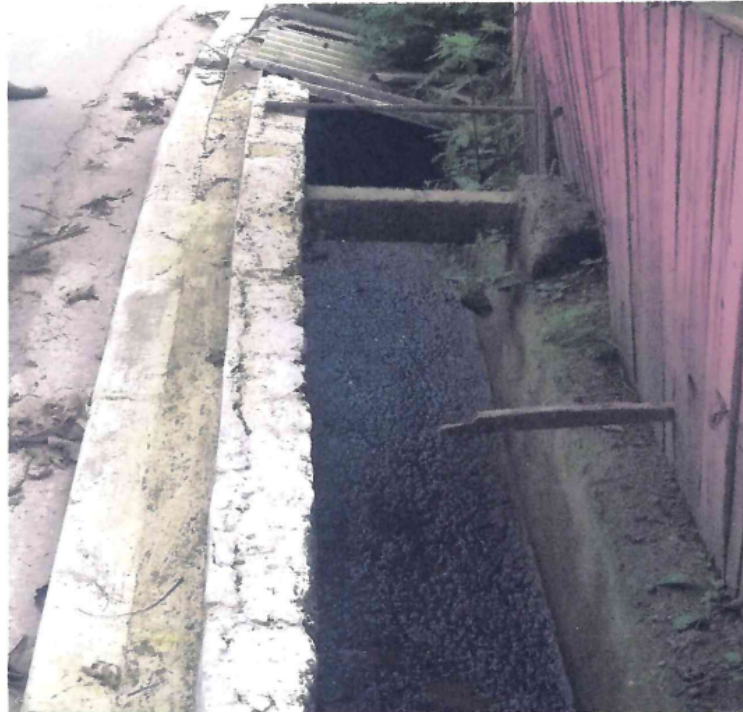
Canaleta suja e sem tampa na Estrada Itacoti (Roque Rodrigues), no Bairro São João.
