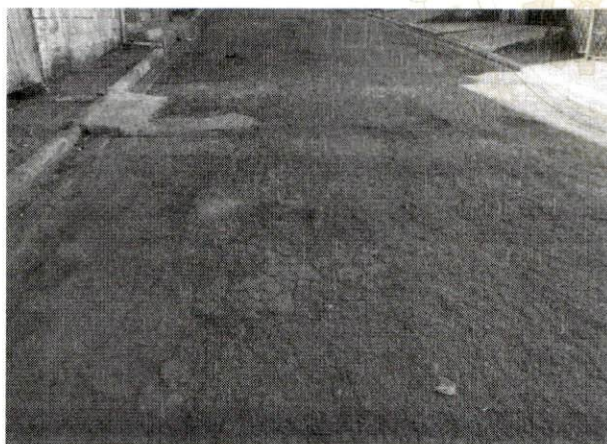
Outro ponto da referida rua que sofre com a deterioração
