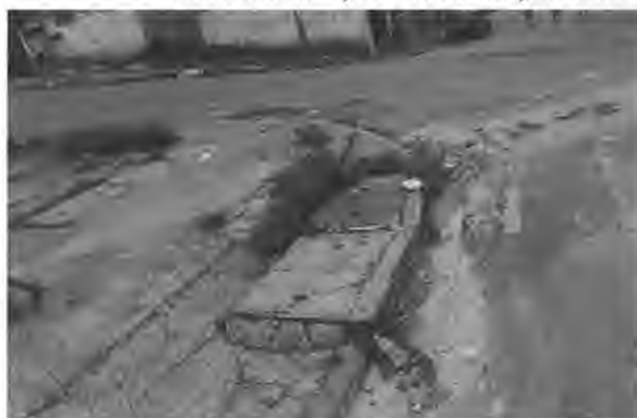
Um dos bueiros obstruídos na Rua dos Rio Branquenses
