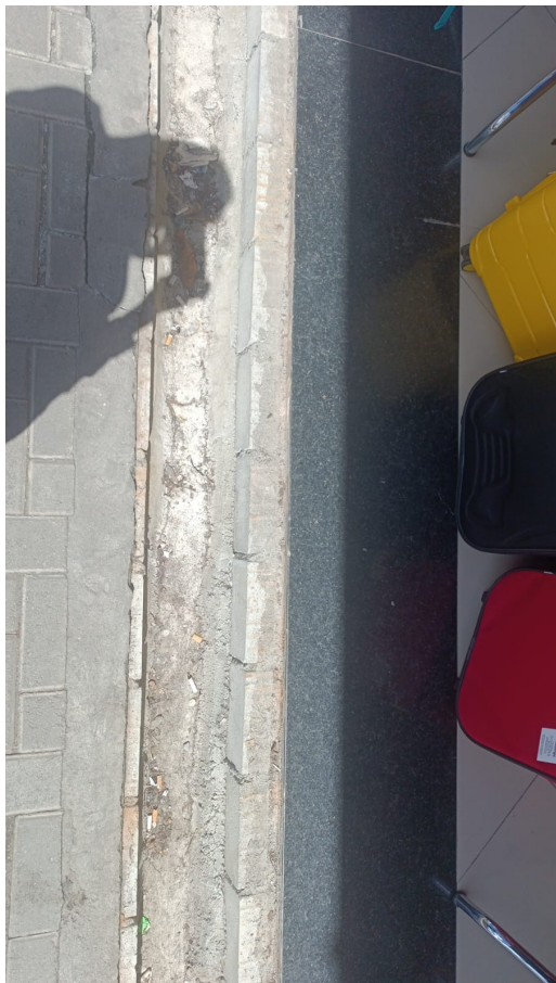
Sem a grade após o furto
